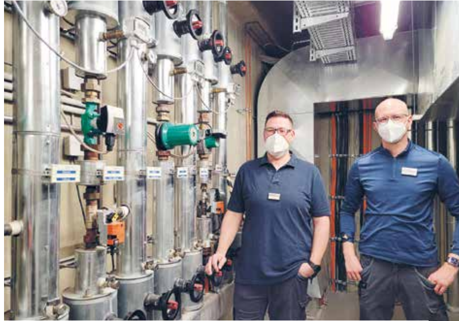
Tim Krause (l.) und Sascha Stollwerk vom Technischen Dienst der Alexianer Köln GmbH freuen sich über die Einführung der Gebäudeleittechnik auf dem Alexianer-Gelände in der Kölner Straße 64. Foto: Volk
