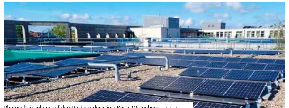
Photovoltaikanlage auf den Dächern der Klinik Bosse Wittenberg
