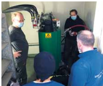
Bereits am Nachmittag desselben Tages war der neue Transformator betriebsbereit
